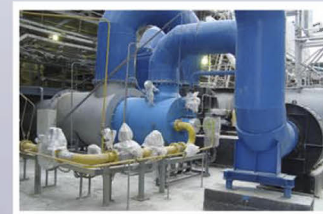
АО БФ «Апатит», Барабан-гранулятор сушилка БГС (6 шт.) Генераторы горячего газа ГГ-75 и ГГ-100. Объем теплоносителя 75000 м 3 /ч и 100000 м 3 /ч.
