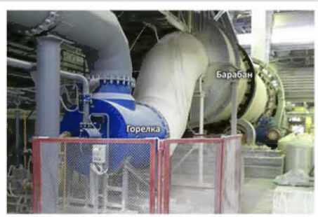
АО БФ «Апатит», Барабан-гранулятор сушилка БГС Горелка ГСС-3000Р-ИС (30МВт) Объем теплоносителя 30000 м 3 /ч
