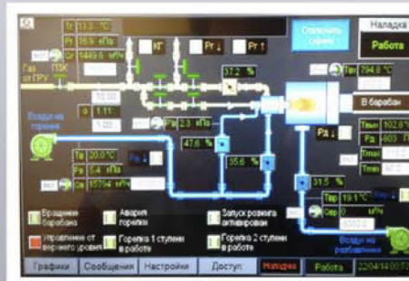
ЗАО «Метахим», АСУ ТП системы отопления сушильного барабана
