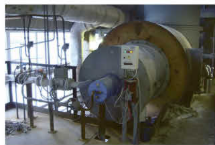
ООО «БМУ», Цех минеральных солей, установка концентрирования и обесфторивания осветленной ЭФК. Горелка ГСС-3000 ИС (30 МВт)
