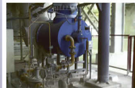
ООО «БМУ», цех минеральных солей, сушильный барабан ФОК-2. Горелка ГСС-3000ИС (30 МВт)
