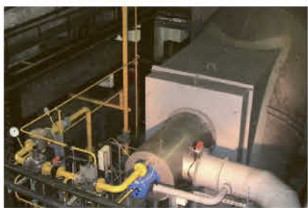
ОАО «Оскольский Электрометаллургический комбинат», Котел-утилизатор Г-1030. Горелка ГСС-1000ИС (10 МВт)
